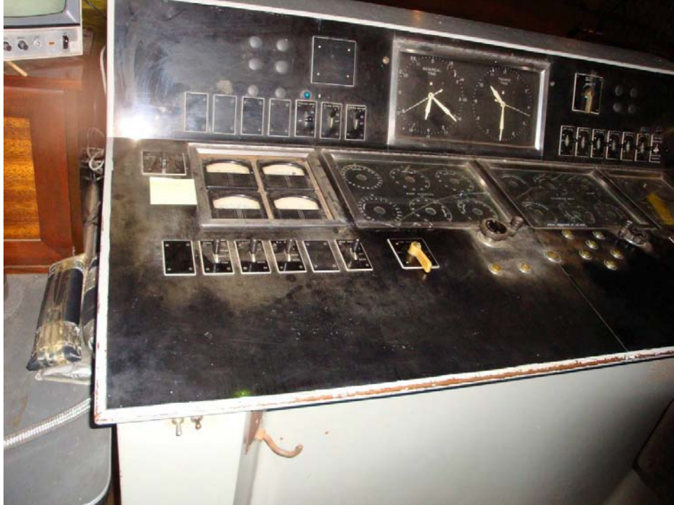
Het originele, nog steeds functionerende bedieningspaneel
